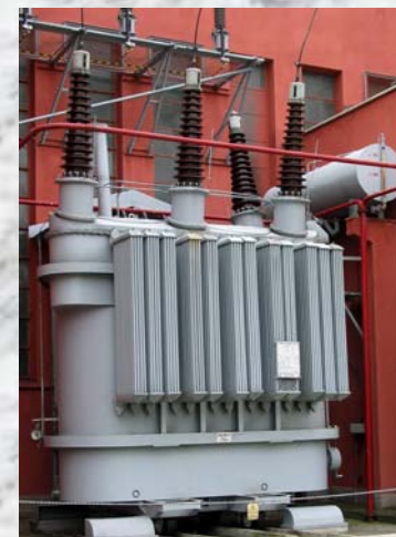
Трансформатор с 1942 г.
